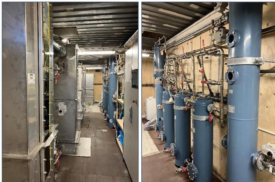
Figur 5. Pilotanläggningen med kolfilter (vänster) och jonbytarfilter (höger, de tre mindre filter är uppströmsfilter).
