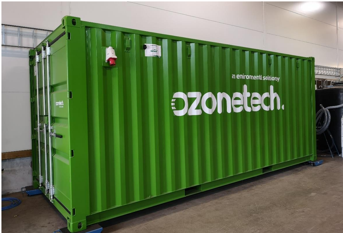
Figur 5. Exteriör på containerlösning med integrerad Ozonotech RENA Tellus inför installation vid Tierps reningsverk.
