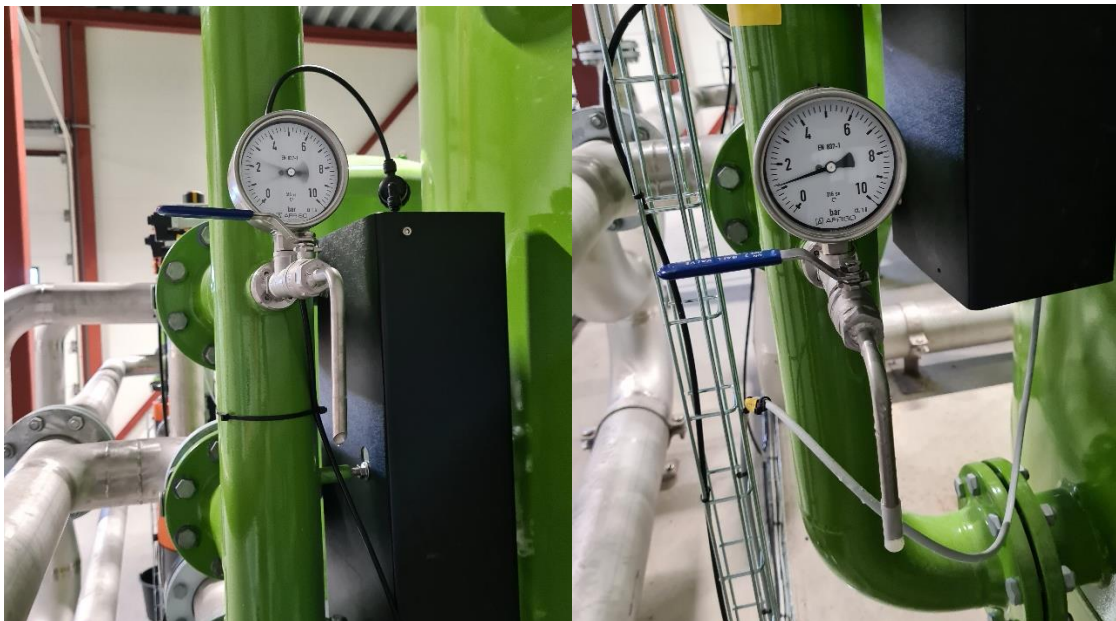
Figur 19. Provtagningspunkter "Efter ozonering" till vänster och "Efter kolfilter" till höger.
