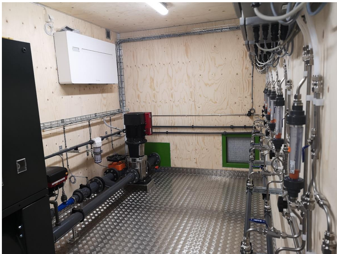
Figur 7. Interiör i installerade containrar i anläggningen. Bilden visar pumpar, ozoninjektor samt klimatanläggning.
