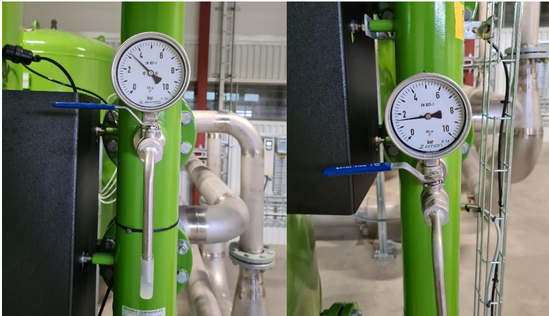
Figur 18. Provtagningspunkter "Före sandfilter" till vänster och "Efter sandfilter" till höger.
