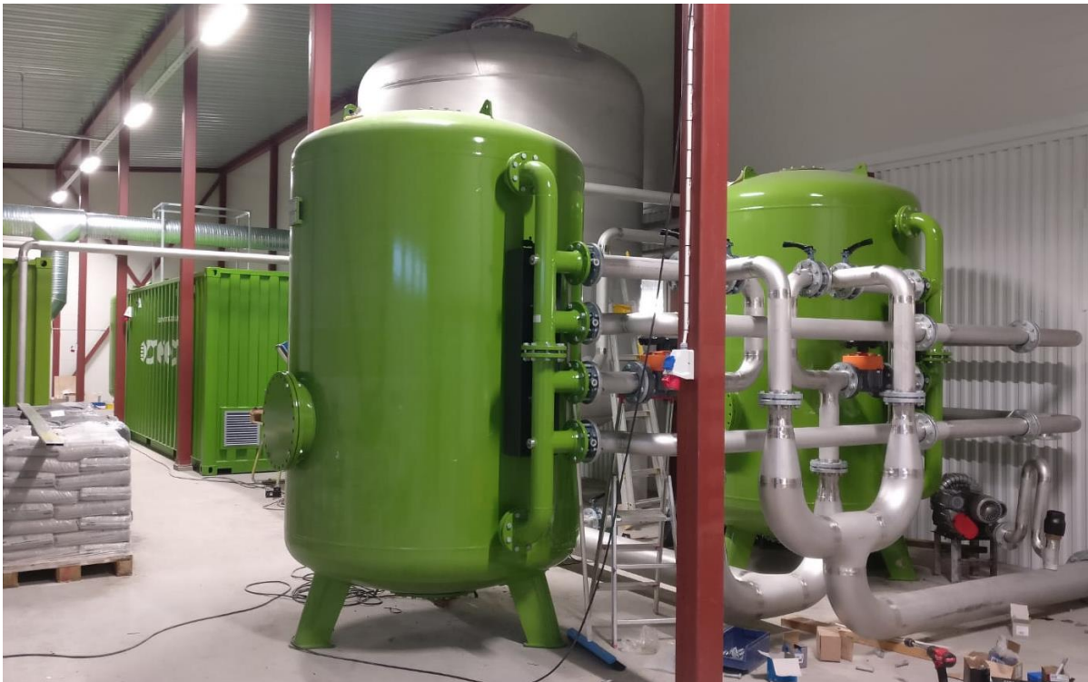
Figur 4. Två installerade Watermaid FlexKarb™-S vid anläggningens inlopp.
