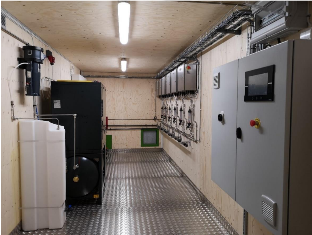
Figur 6. Interiör i installerade containrar i anläggningen. På bilden visas kompressor, kylvattensystem, styrpanel samt sex installerade Ozonetech ICT-80 ozongeneratorer.
