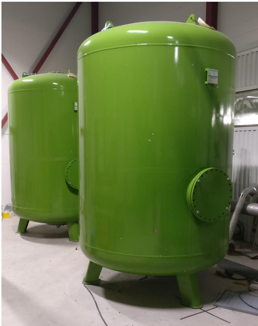
Figur 8. Två installerade Watermaid FlexKarb™-C GAK-filter vid anläggningens sista reningssteg och utlopp.
