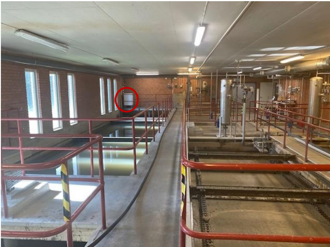
Figur 5, Bassänger samt provtagningsplats efter mekaniskt reningssteg markerat med röd cirkel
