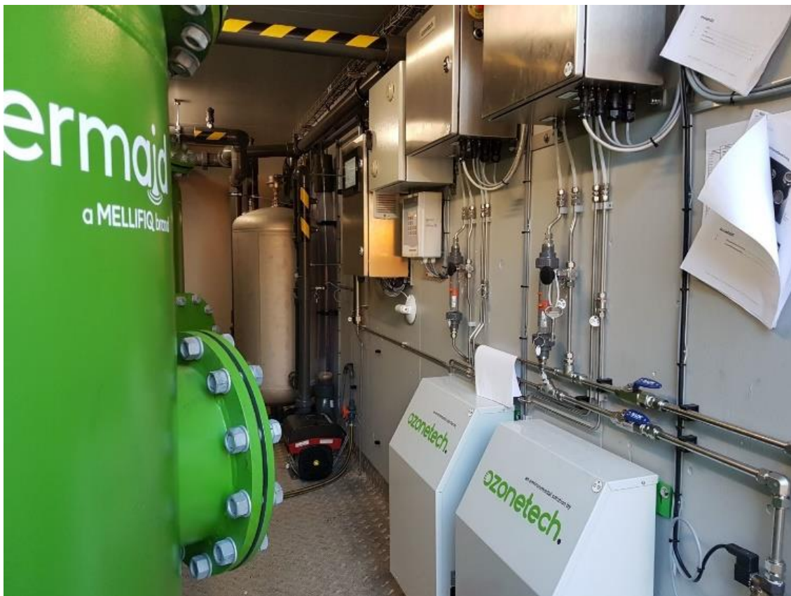
Figur 8. Interiör i installerade containrar i anläggningen. På bilden syns två ICT-80 generatorer samt sandfiltertank i förgrund.
