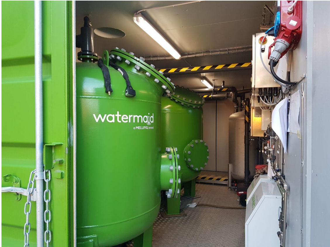
Figur 6. Installerad Watermaid FlexKarb™-S sandfilter vid anläggningens inlopp (första tanken i bild).
