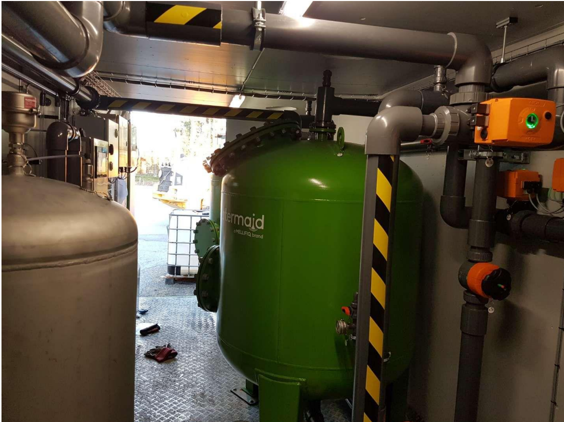
Figur 9. Installerat Watermaid FlexKarb™-C GAK-filter vid anläggningens sista reningssteg och utlopp.
