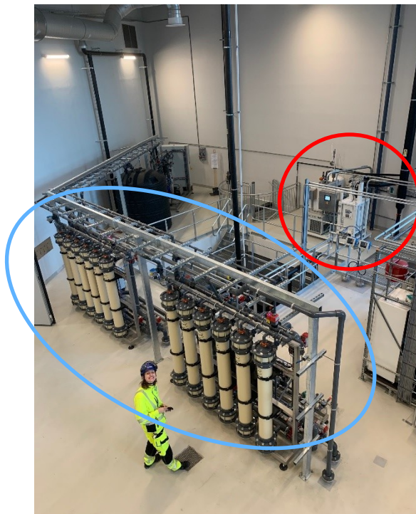
Figur 4 Överblick över läkemedelsreningen. Ozon utrustning i röd ring och nanofilter i blå.
