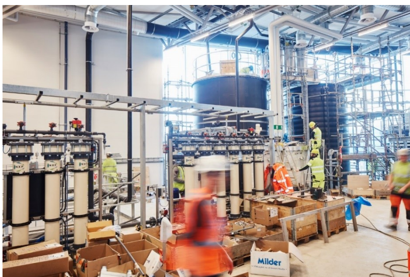
Figur 2: Nanofiltrering på plats i Reco Lab. Inkoppling pågår.
