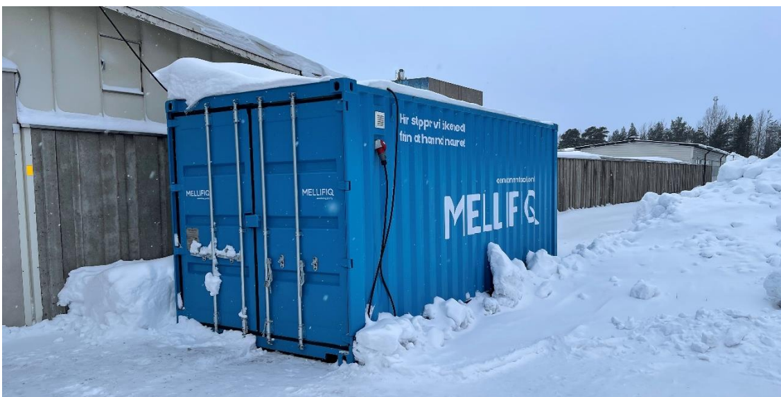
Figur 4. Utsidan av reningsanläggning, väderskyddad och containerbaserad.
