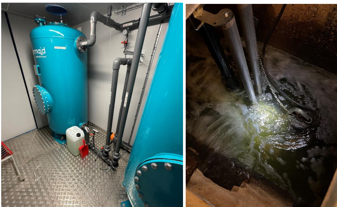
Figur 3. Tv: Water Maid FlexKarb sandfiltersystem samt kolfiltersystem. Th: pumpsump från vilken processvatten pumpades till reningsanläggning med dränkbar pump.
