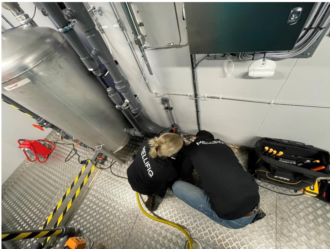
Figur 2. Installationstekniker från Mellifiq under driftsättningsarbete. Till vänster syns ozonreaktionstank. Överst syns ozongenerator och säkerhetssensor.
