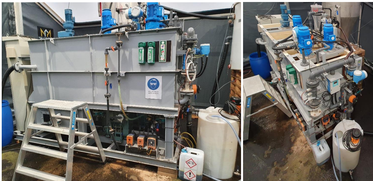
Figur 6.1: Actiflo-pilotanläggningen (t.v. från sidan, t.h. snett uppifrån)
