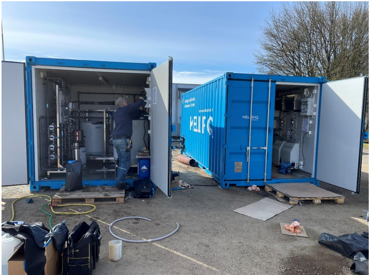
Figur 5. Installation av containerbaserad nanofilteranläggning och ozon-GAC-process inkl. sandfilter från Mellifiq.
