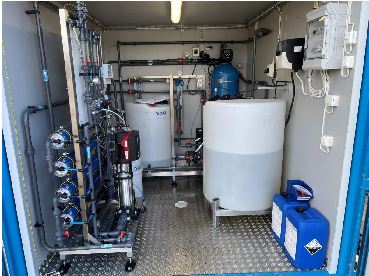
Figur 6. Nanofiltersystem Water Maid™ NF1 för att rena upp till 1,8 m 3 /hr processvatten, installerad parallellt med ozon-GAC-linje.
