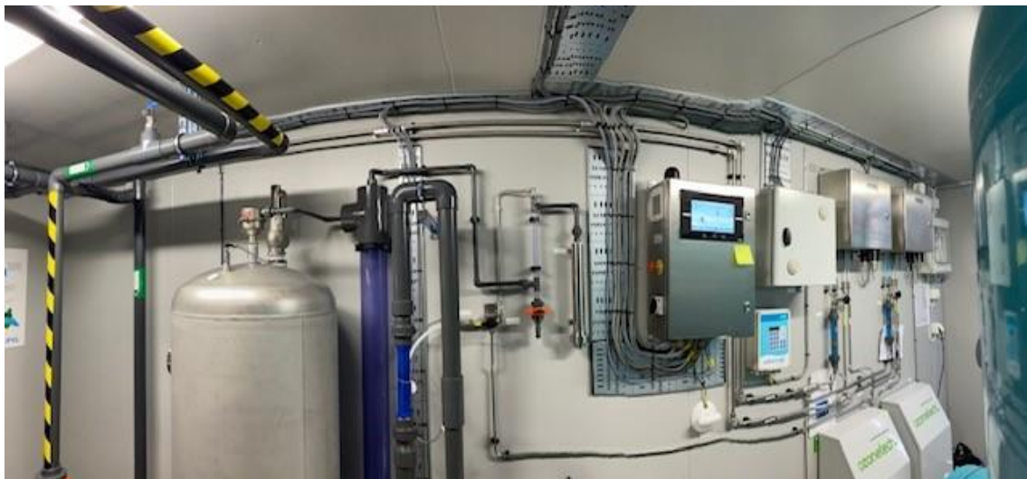
Figur 19 Utrustning för ozonbehandling i pilotanläggningen.
