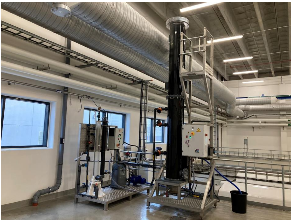
Figur 2.4. Översiktsbild av pilotanläggningen.
