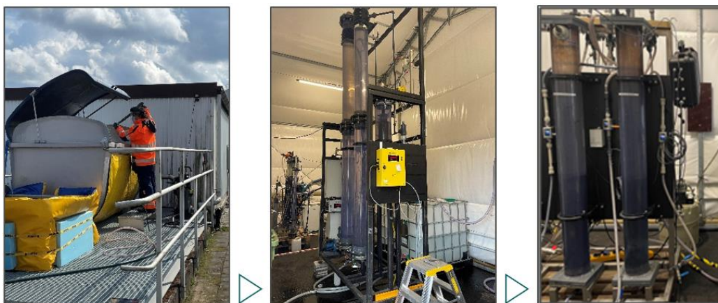
Figur 4. Pilotanläggning med teknikkombinationen MF, O3 och GAK.
