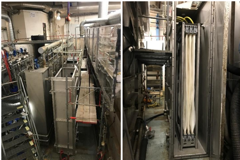
Figur 4. Membrantankarna under installation och membrankassett med tre membranmoduler.
