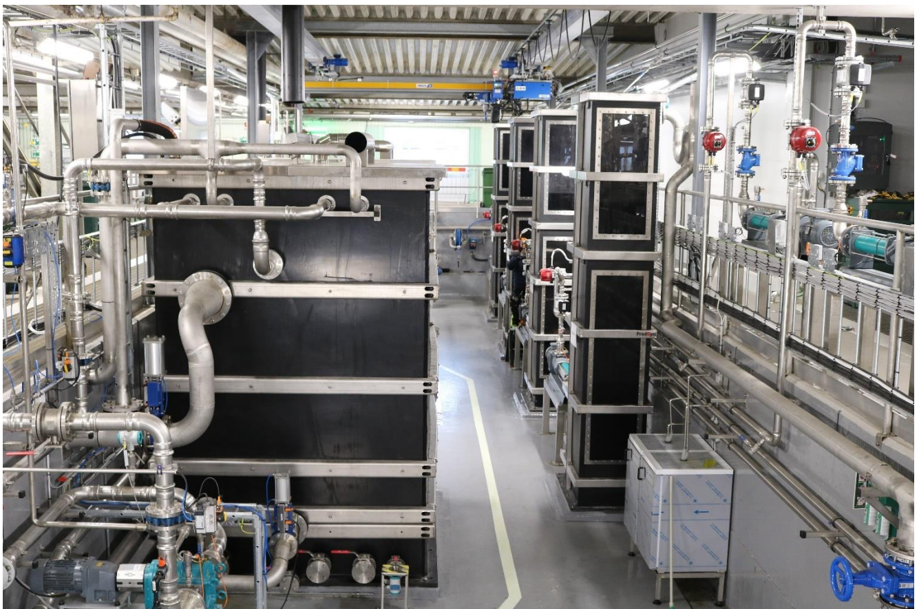
Figur 2 MBR-GAK pilotanläggningen med membrantankar till vänster och de fyra GAK-filtren till höger.
