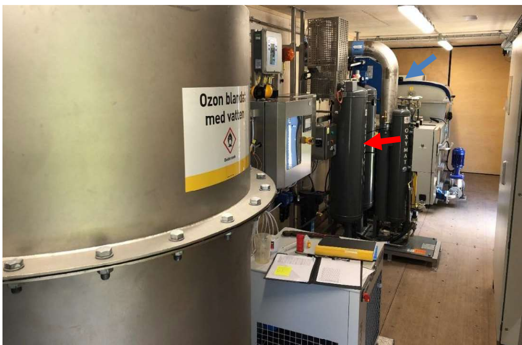
Figur 2. Översiktlig bild över anläggningen. Längst bort i bild trumfiltret (markerad med blå pil) varpå ozonanläggningen för tillverkning av ozon följer (markerad med röd pil).
