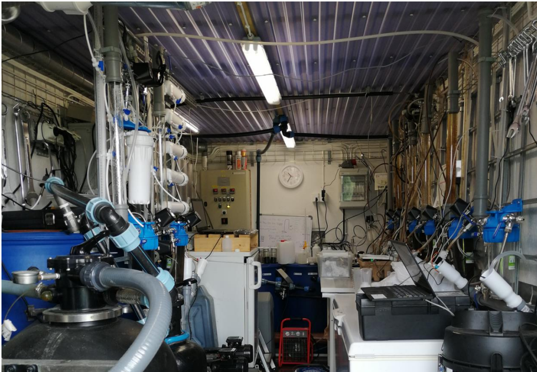
Figur 2. Interiör av pilotanläggningen. Ultrafilter och pilotlinjer till vänster, labkolfilter till höger.
